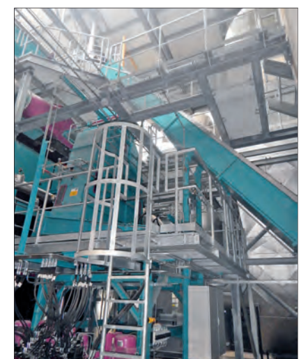
Der Auftraggeber legte großen Wert auf eine gute Zugänglichkeit und Wartungsfreundlichkeit aller Anlagenkomponenten.
