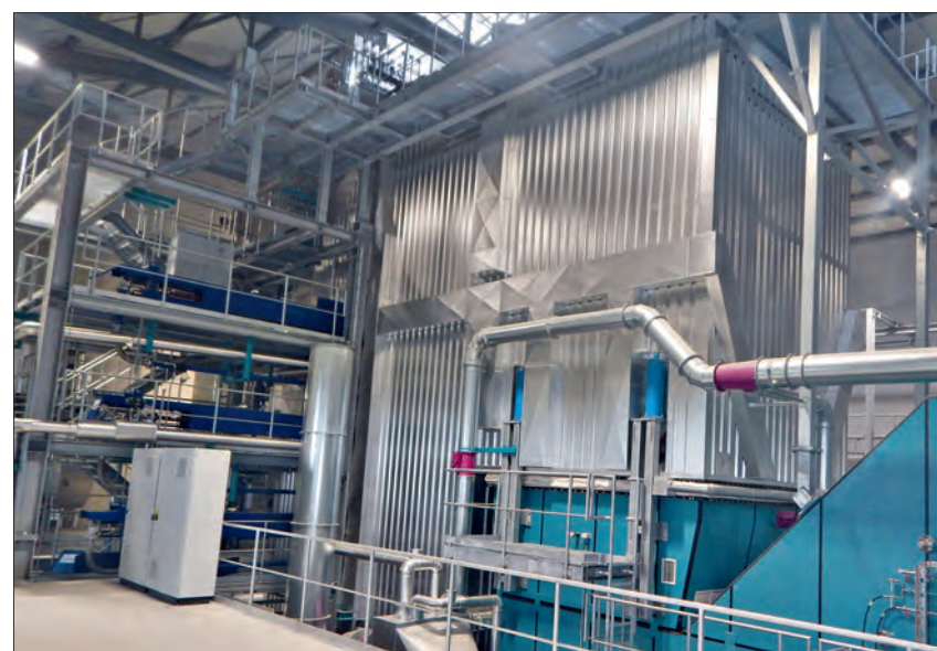
Hochdruckheissdampfkesselanlage mit 22 MW Leistung
