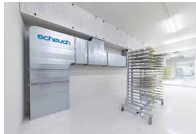
Die Lackieranlage besteht aus einem Spritzplatz, ...
