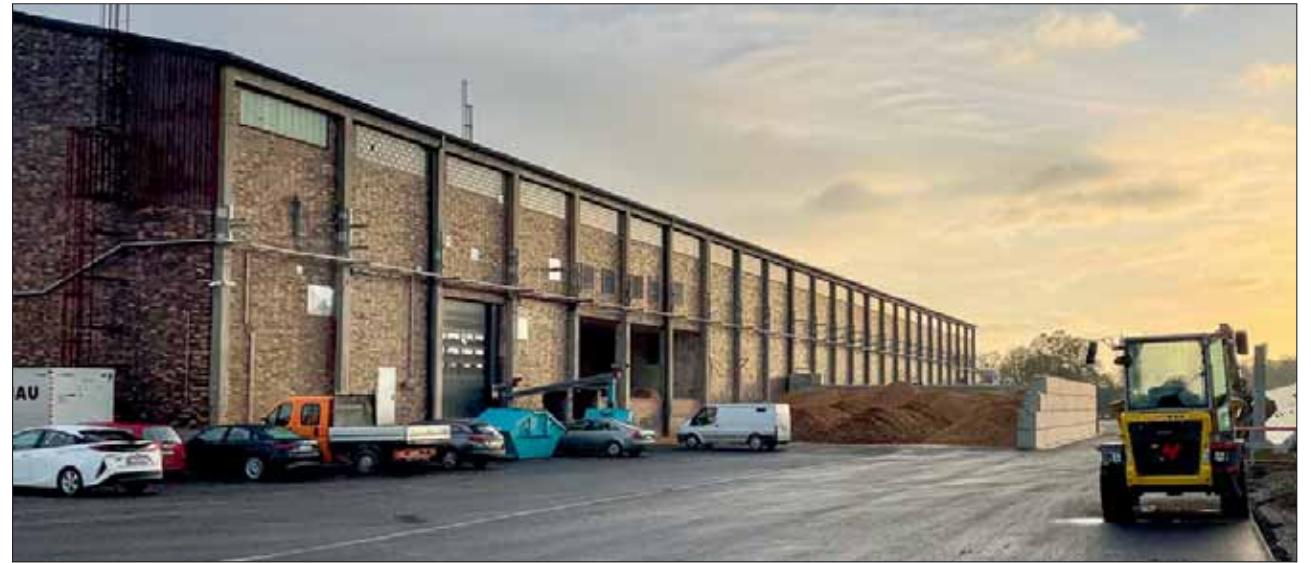
Die Heizungsanlage konnte in einem Bestandgebäude aus dem frühen 20. Jahrhundert untergebracht werden.
