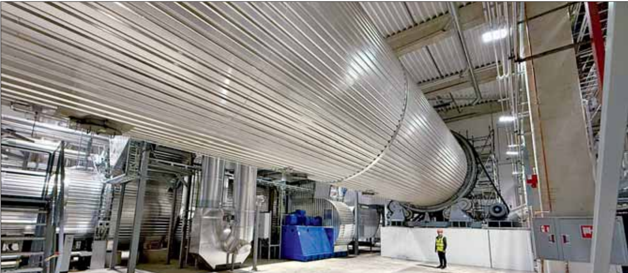
Die Biomasse wird in einem rotierenden Reaktor torrefiziert. Dieser hat einen Durchmesser von 5 m und ist rund 20 m lang.
