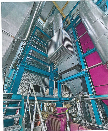
Die Polytechnik-Anlage verarbeitet Biomasse mit einem Wassergehalt von 20 % bis 60 %
